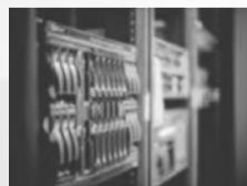
Контейнерный центр обработки данных
